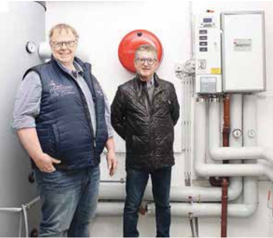
Leopold Marschnig (li.) bei der Übergabe einer neuen Fernwärme-station mit Günther Essenko. Foto: KK
